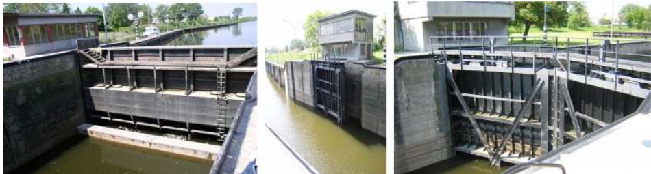
Slika 1.10: Prevodnica na kanalu Novi Sad – Savino selo, u okviru sistema DTD; sleva udesno: uzvodna glava komore sa spuštajućom tablastom ustavom i nizvodna glava sa otvorenom i zatvorenom dvokrilnom kapijom [39].
