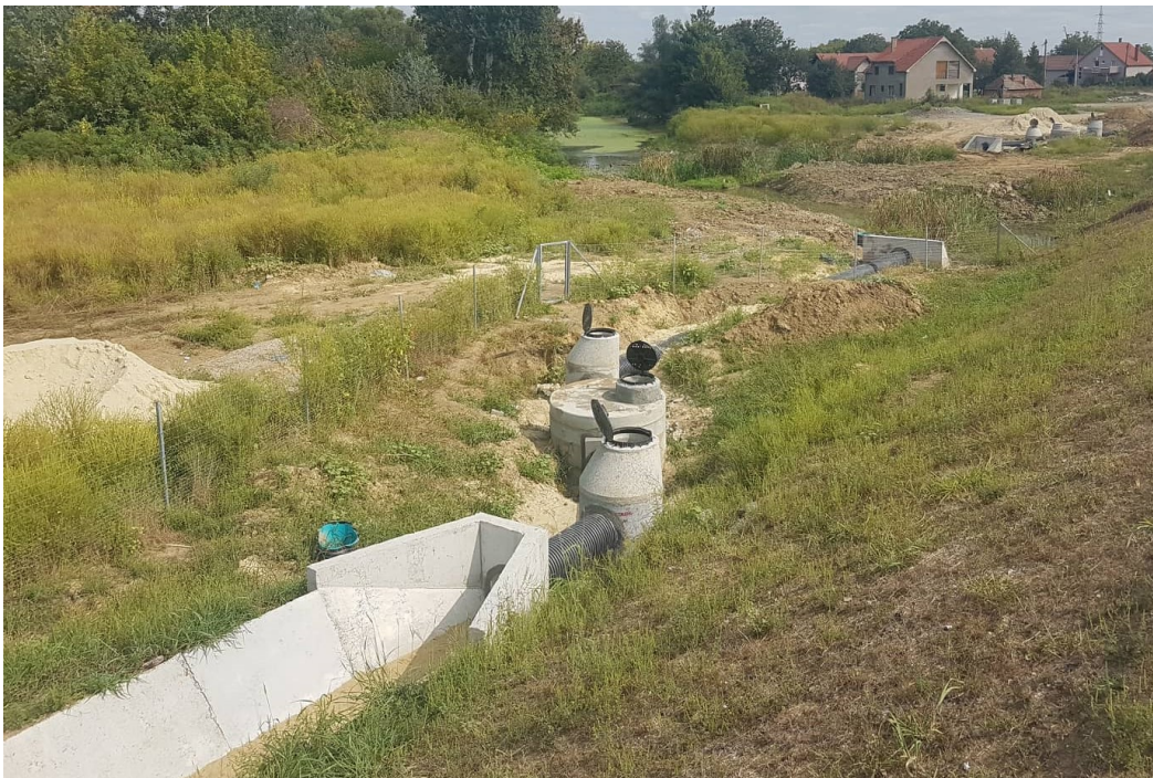
Slika 20. Na auto putu E-763 Obrenovac Ub je dat detalj izliva iz dva separtora u staraču Tamnave
