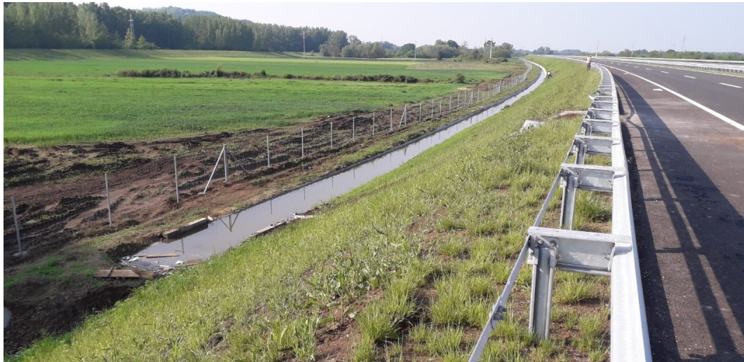
Slika 4. Primer Auto puta E 763 Obrenovac - Ub: Otvoreni betonski kanal sa problemom izlivanja
