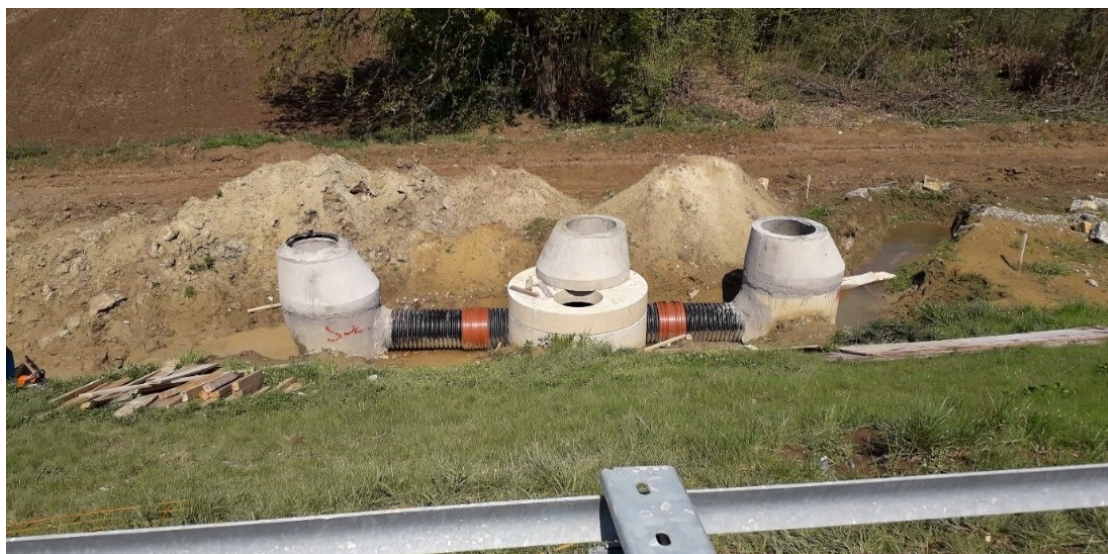
Slika 13. Auto put E 763 Obrenovac - Ub i primer ugradnje betonskih separatora Q=20/250 l/s
