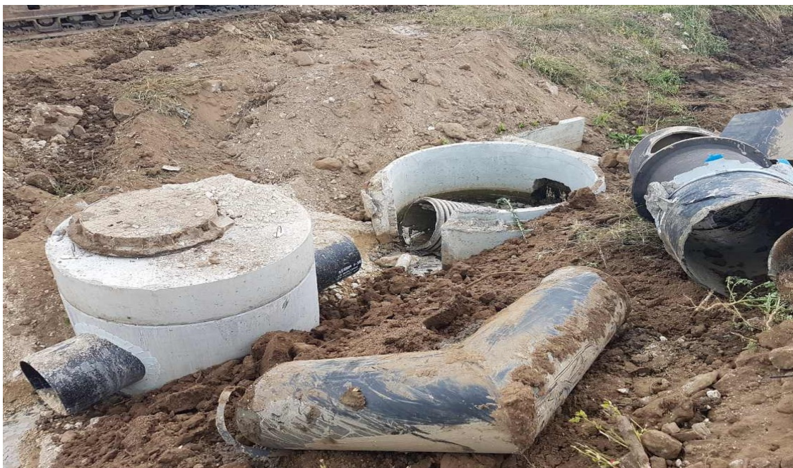
Slika 18. Neuspašan pokušaj podizanja separatora zbog greške u postavljenoj koti
