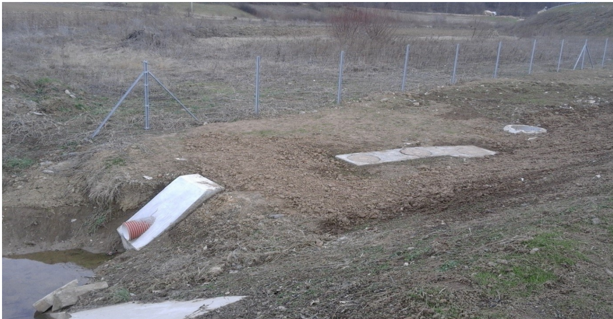
Slika 17. Na auto putu E 763 je ugrađen plastični separator sa izlivom u otvoreni kanal
