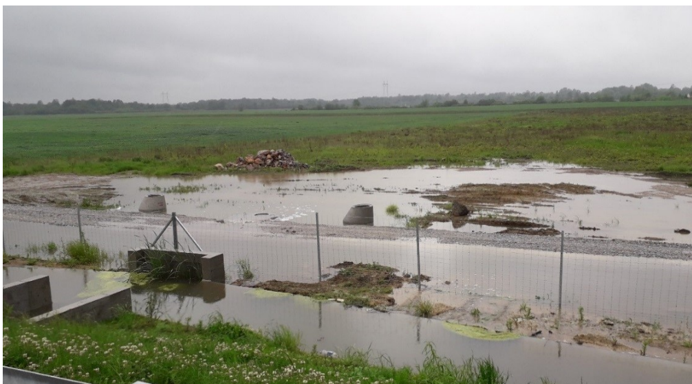
Slika 21. Na auto putu E-763 je veliki problem bio izlivanje vode iz sistema tokom visokog nivoa podzemnih voda na deonici Obrenovac- Ub, maja mesec 2019. godine
