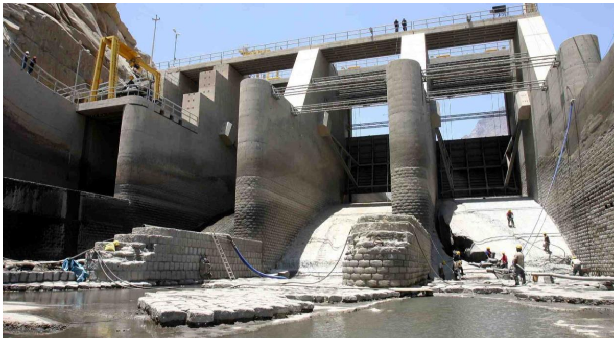
Slika 6. Brana Chavimochic, oštećenja preliva i slapišta usled nedovoljne zaštite
