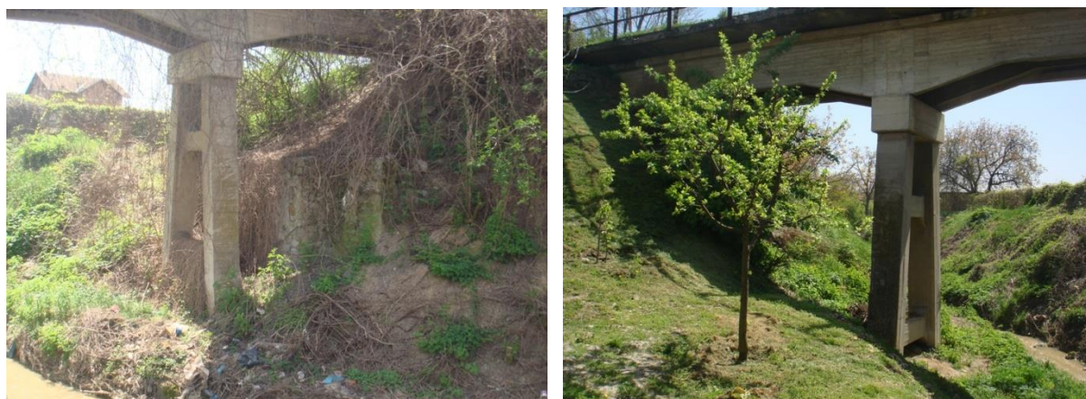
Slika 3. Stub železničkog mosta na Rokovom potoku posle poplava 2014.god.
