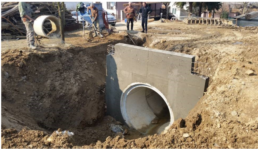
Slika 5. Ulivni objekat u cevovod u izgradnji u Tekiji, mart 2015. Figure 5. Culvert inlet under construction in Tekija, March 2015.
