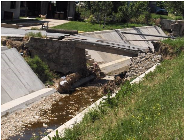
Слика 9. Оштећен мост Figure 9. Damaged bridge
