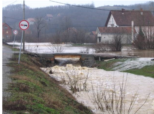
Слика 2. Успор настао од локалног моста Figure 2. Backwater caused by bridge.
