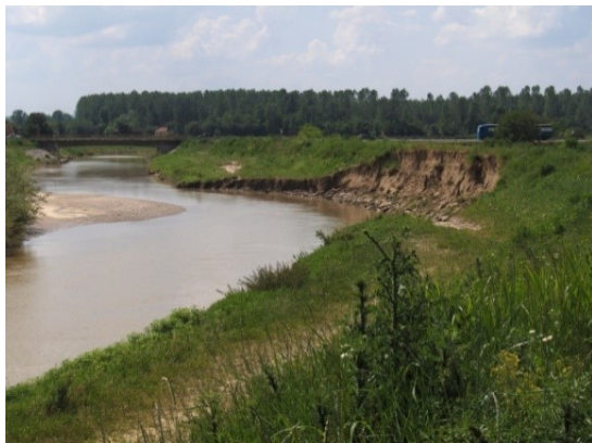
Слика 3. Оштећена обала и косина насипа на km 3
