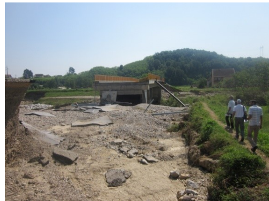
Слика 4. Оштећене обала и срушене навозне рампе друмског моста у Горњем Добрићу на km 11
