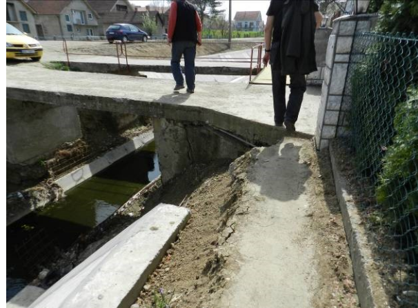
Слика 8. Прекид армирања у зони моста Figure 8. Channel discontinuation
