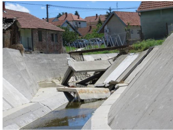
Слика 10. Оштећено корито Figure 10. Damaged riverbed
