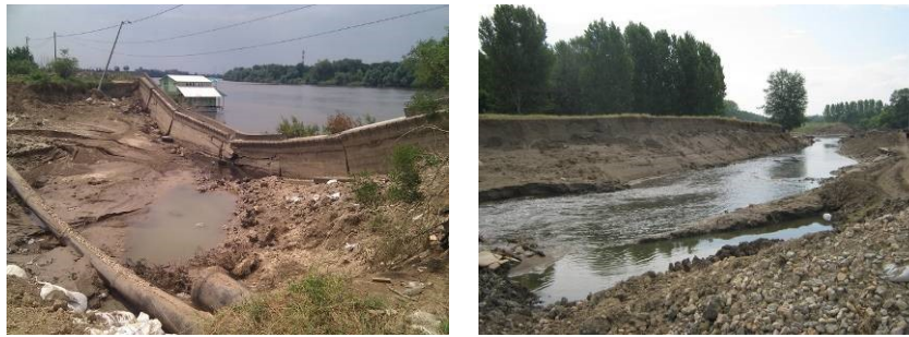
Слика 7. Слегао АБ зид и пробој насипа Figure 7. Collapsed reinforced concrete wall and levee breach
