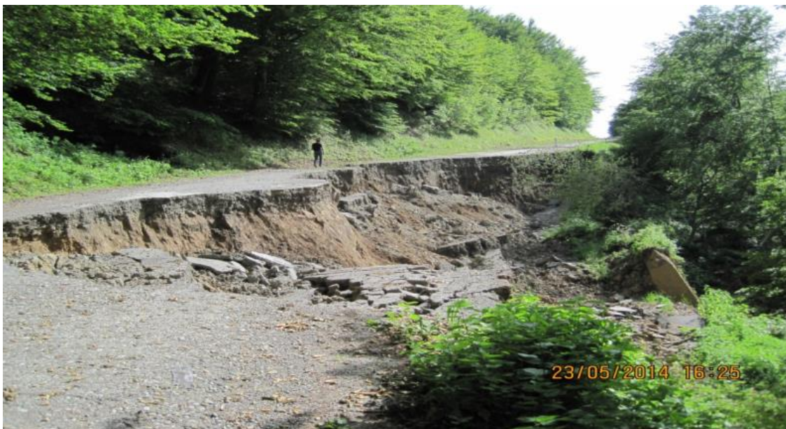
Слика 4 – Клизиште на државном путу IIА-137 Крупањ - Мачков Камен - Грачаница, km:6+900. Клижењем је потпуно уништен труп пута у дужини од 60m.
