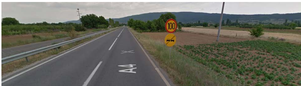
Slika 5. Izostavljena zaštitna i ograda od žice na putevima sa dozvoljenom brzinom većom od 100 km/h na magistralnom putu A4, deonica Prilep - Bitolj Izvor: Google Maps/Street view
