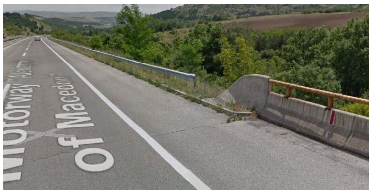
Slika 3. Neodgovarajući spoj elastične ograde sa ogradom na objektu na autoputu A1, deonica Veles-Negotino Izvor: Google Maps/Street view
