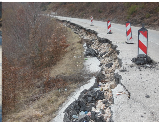
Slika 10. Klizište "Zelenovići" Izvor: (Arhiva AD "Novi Pazar – put")
