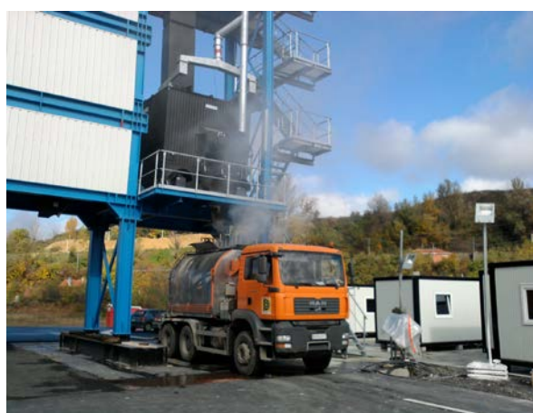
Slika 2. Postrojenje za proizvodnju livenog asfalta i koherica za transport livenog asfalta (JKP "Beogradput")
