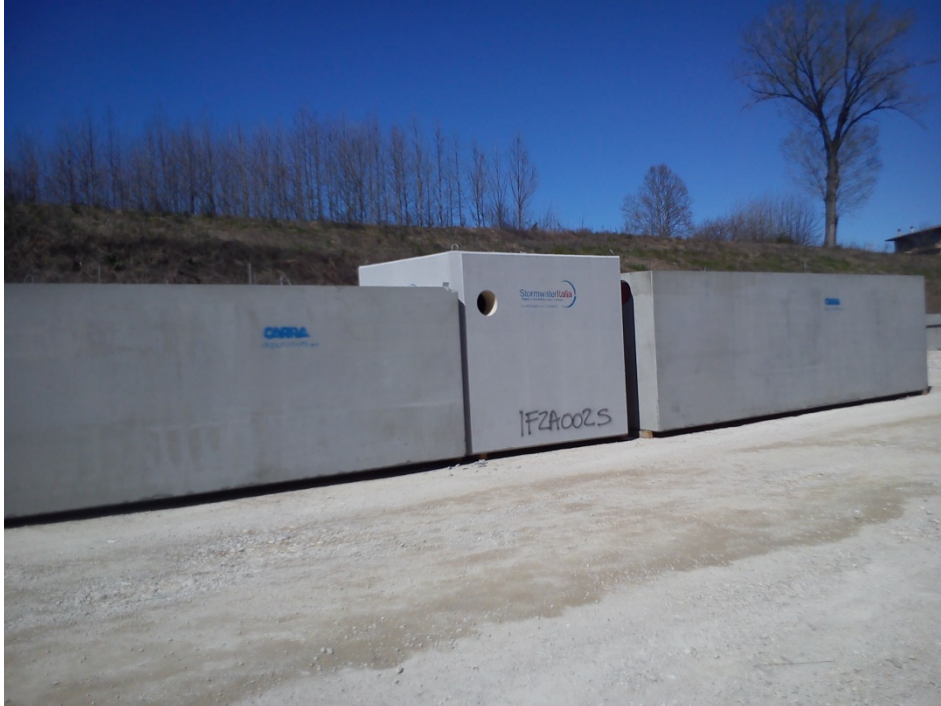
Slika 6. Sistem za kontrolu i usmeravanje SWERM (u sredini), trajno zadržavanje veoma zagađenog oticaja (levo) i prečišćavanje (desno) kišnog oticaja na autoputu Udine – Vičenca
