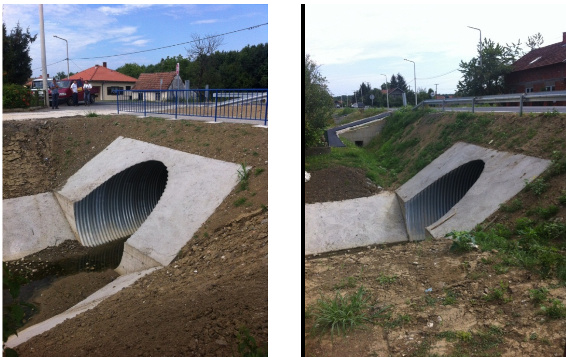
Slika 15. I 16. Gotovi propust od čelične spiralne cijevi HC DN3000 – Gunja – D214;
