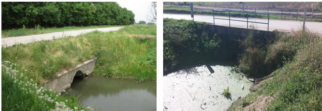
Slika 5. i 6. Oštećenje propusta zbog nedovoljne protočnosti;
