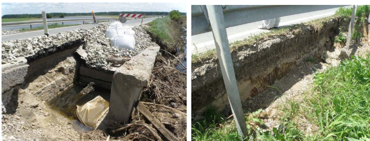
Slika 3. i 4. Oštećenje uz kolnik na bankini i propustu - Gunja;
