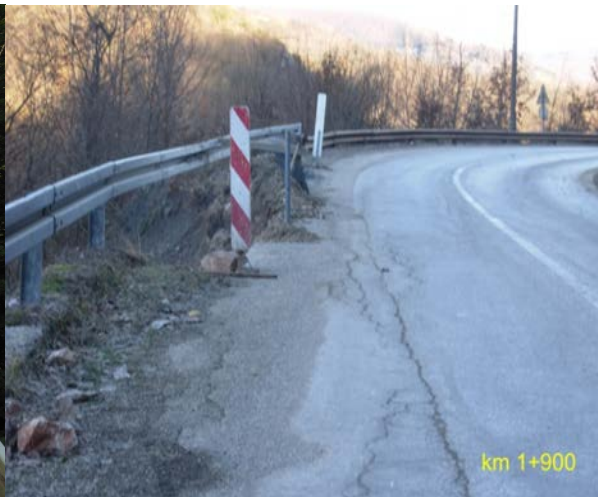
Slika 13. Oštećenje u zoni bankine Izvor: (Arhiva AD "Novi Pazar – put")
