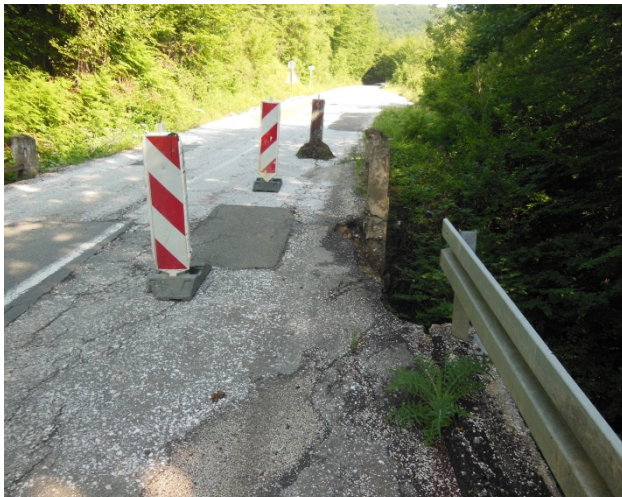
Slika 12. Oštećenje na propustu Izvor: (Arhiva AD "Novi Pazar – put")
