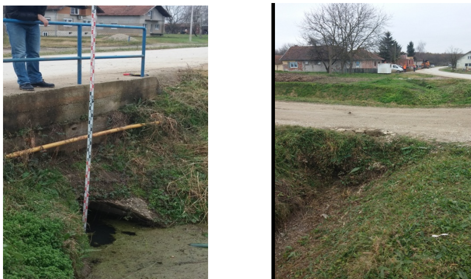
Slika 7. i 8. Oštećenje propusta zbog nedovoljne protočnosti;
