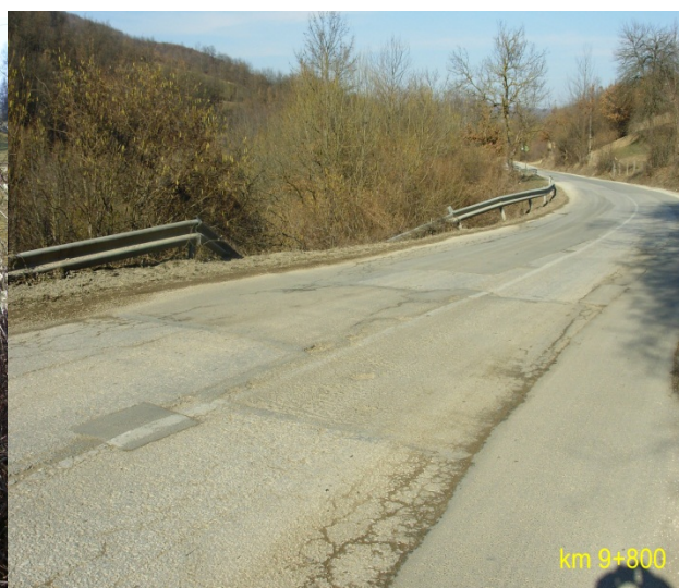
Slika 15. Oštećena zaštitna ograda
