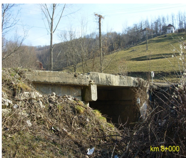
Slika 14. Zaštitna ograda ne postoji
