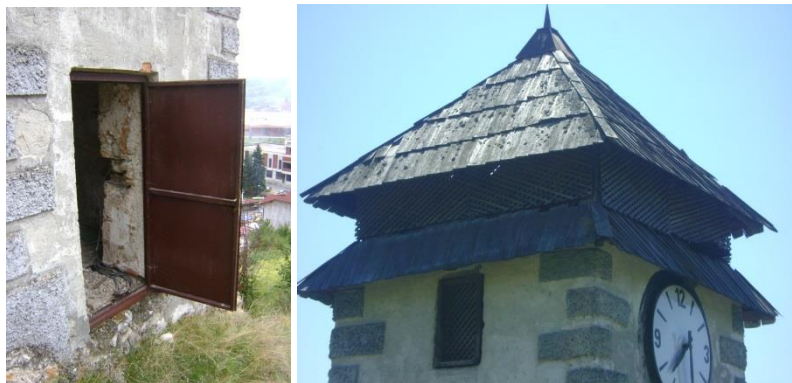
Slika 6 – Prikaz postojećeg stanja ulaznih vrata i oštećenja mušebaka
