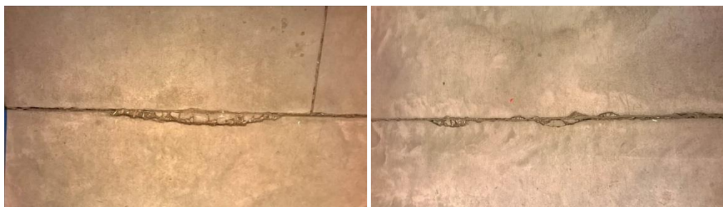
Slika 9 – Primeri ostećenja podne ploče na dilataciji - primer iz Srbije
