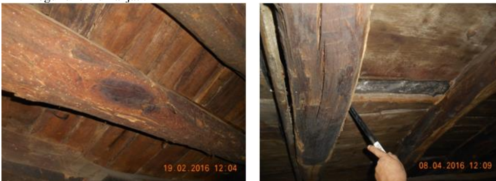
Slika 3 –Međuspratna greda sa slikom tipičnih oštećenja izazvanih dejstvom insekata, lošom preventivnom zaštitom i selekcijom materijala
