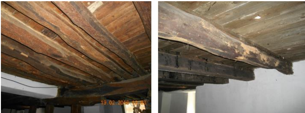
Slika 2 –Deterioracija neadekvatno zaštićene drvene međuspratne konstrukcije usled bioloških uticaja
