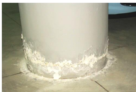
Efekt kapilane apsorpcije vode u betonu
