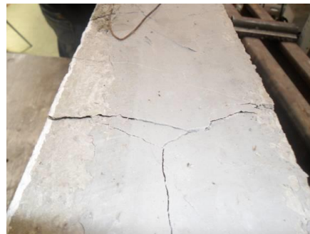
Slika 13 – Karakterističan raspored prslina (gornja strana nosača)
