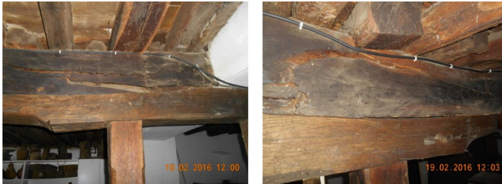
Slika 5 – Oštećenja centralne, noseće grede MSK
