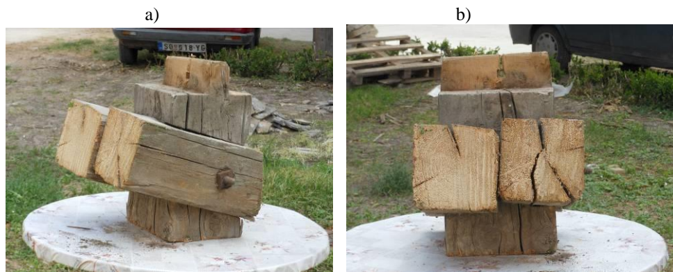
Slika 11 - Ilustracija visokog stepena "ispučnosti" drvene građe u okviru postojećeg krova
