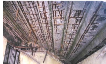
Degradacija betona izloženog na karbonizaciju
