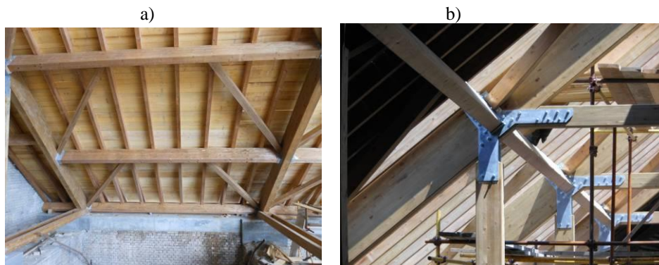
Slika 15 - Izgled dela završene krovne konstrukcije snimljen iz tavanjskog prostora (a) i detalj povezivanja jedne od rožnača sa glavnim vezačem (b)
