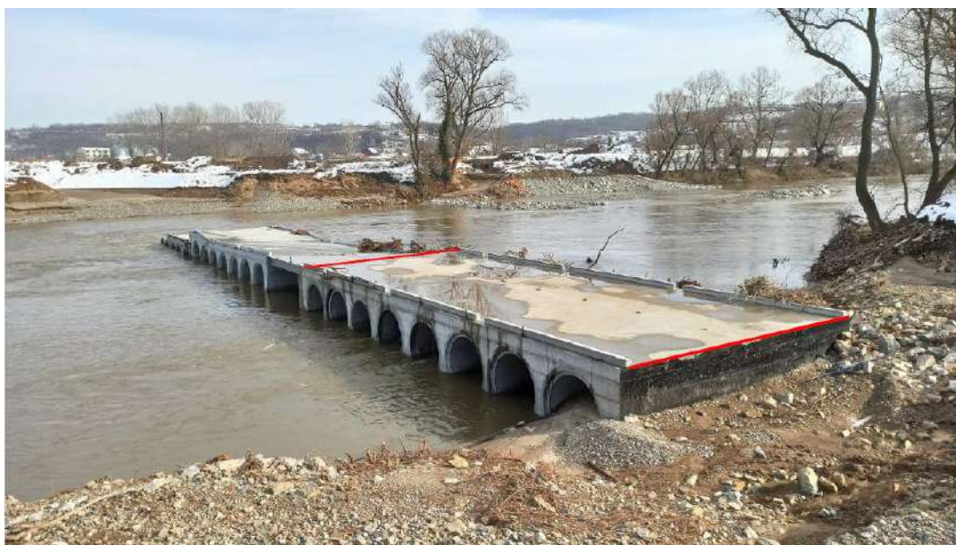
Slika 4. Oštećen objekat, pogled sa leve obale; srednji deo i ploča preko ribljeg prelaza deformisani do neupotrebljivosti, na levoobalnom delu objekta se ne zapažaju oštećenja
