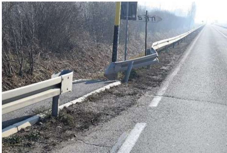
Слика 1. Прекид заштитне ограде
