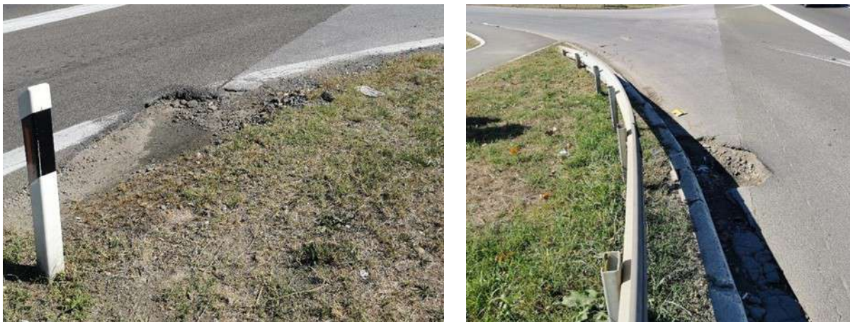
Slika 9. Oštećenje kolovoza usled neadekvatnog odvodnjavanja u zoni priključka (Izvor:[4])
