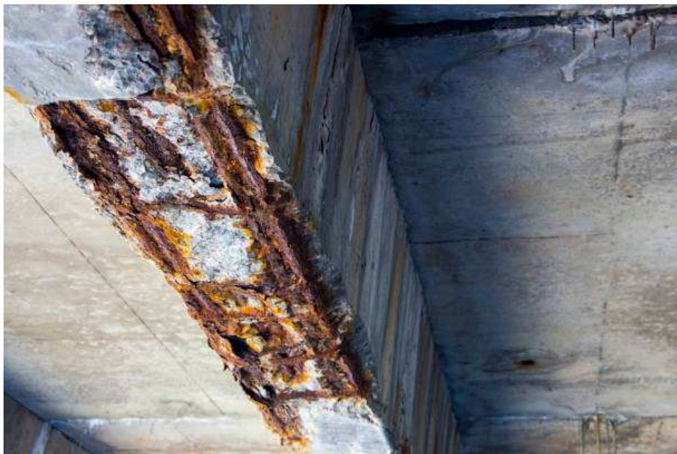
Slika 2. Karakteristično oštećenje konstrukcije od korozije; Source: (Izvor, Istockphoto)
